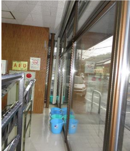
・ 1階ロビー東側ガラス 雨漏り
