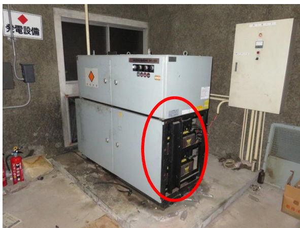
・ 庁舎内非常照明、消防設備用自家発電機 地階 機械室 始動バッテリーの充電ができず、始動できない
