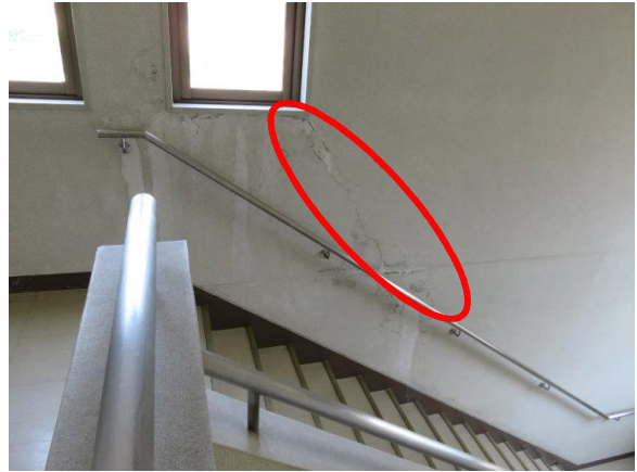
・西側3階 窓から斜め右下に向けてのひび割れ、 ただし、外側についてはシール済み
