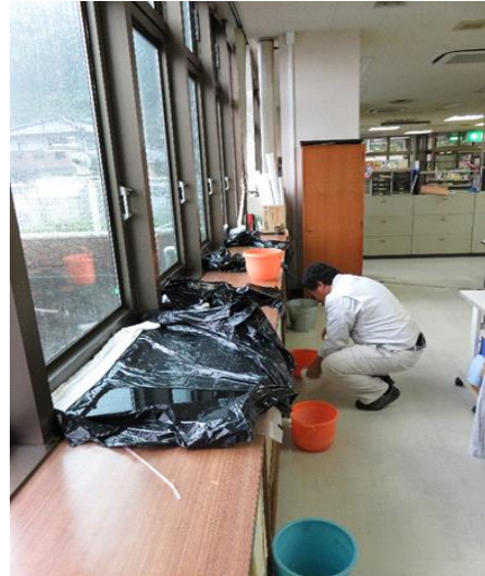
・ 1階北側事務所 雨漏り
