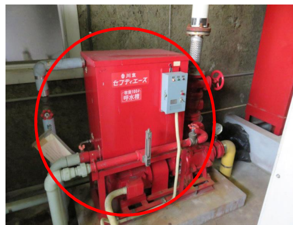
・ ポンプの始動はできるが、消防用タンク内(止水弁)もしくは給水配管の異常により送水できず、予備水槽に水を貯めている
