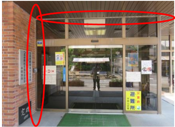
・正面玄関 雨天時、雨漏り有り（左記のとおり）
