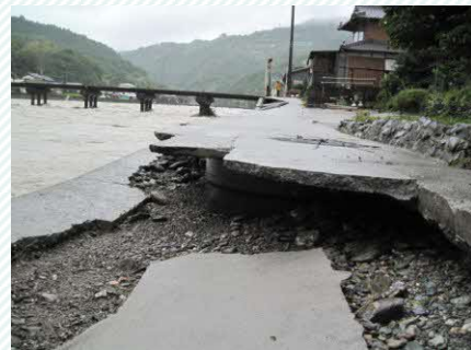
貞光川の増水による被害（長橋下流）
